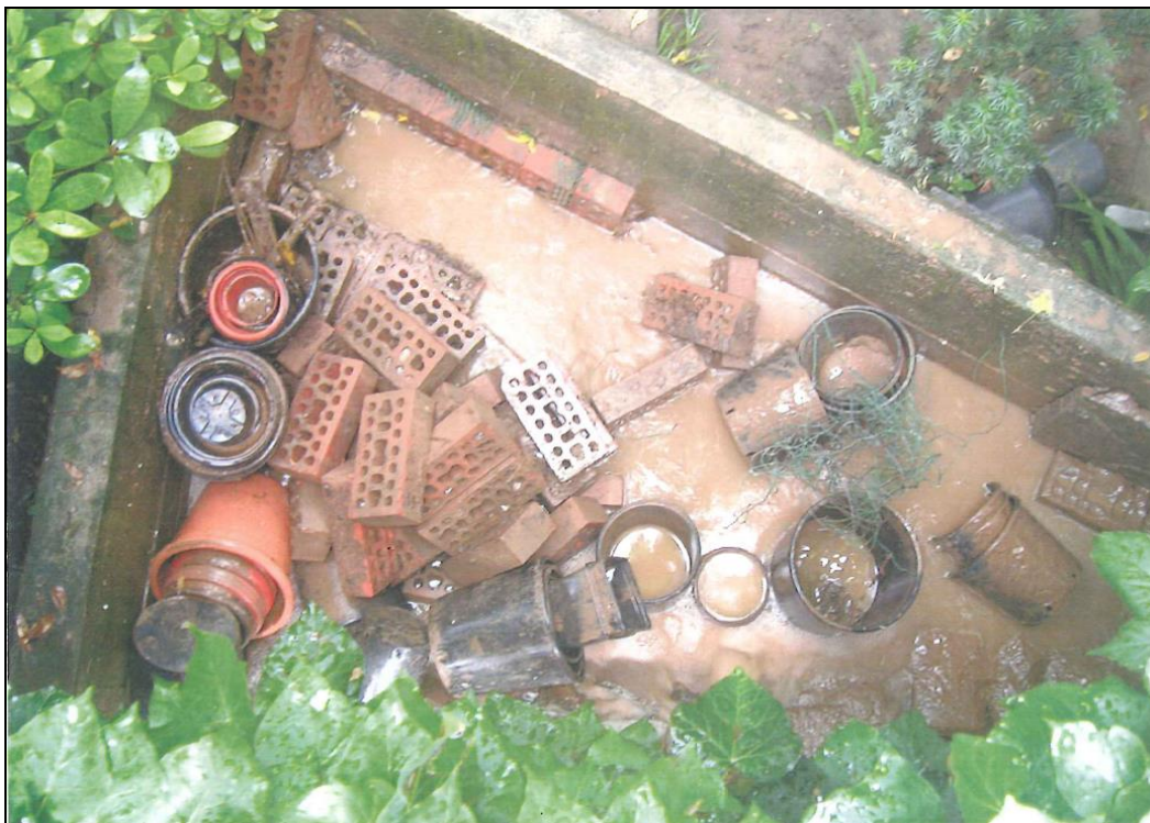
Figura 27 - Allagamento della vasca di calma a valle del muro perimetrale di valle della proprietà Albergo di Villa Melano; il manufatto si trova nell'area di proprietà del civico 16A di Vicolo San Pietro, circa 2 metri più in basso della sommità del muro perimetrale.
