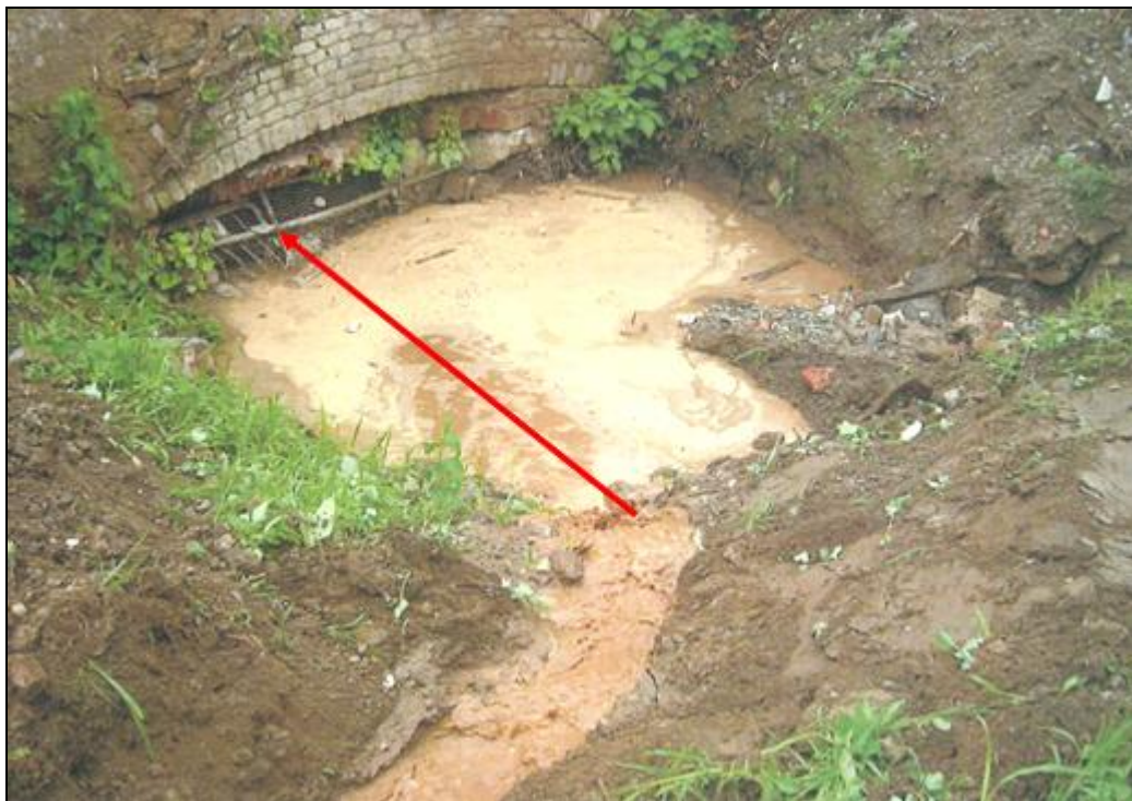
Figura 26 – Occlusione, in corso di evento, del manufatto di attraversamento (in rosso) a monte del muro perimetrale di valle della proprietà Albergo di Villa Melano.
