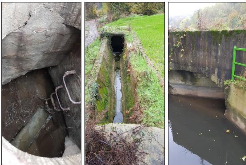
Foto 6 – Nodo di ripartizione, tratto terminale del canale di troppo pieno e scarico in Bealera.
