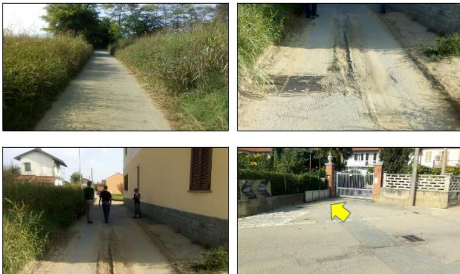
Foto 3 – Evidenti tracce di allagamenti e depositi di materiale.
