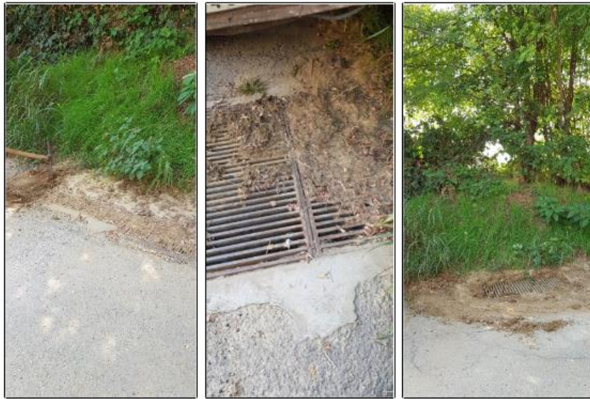
Foto 2 – Strada Vecchia di Rivoli: le griglie risultano inadeguate a convogliare la portata nella rete fognaria mista a causa della cospicua presenza di materiale solido che ostruisce i manufatti.
