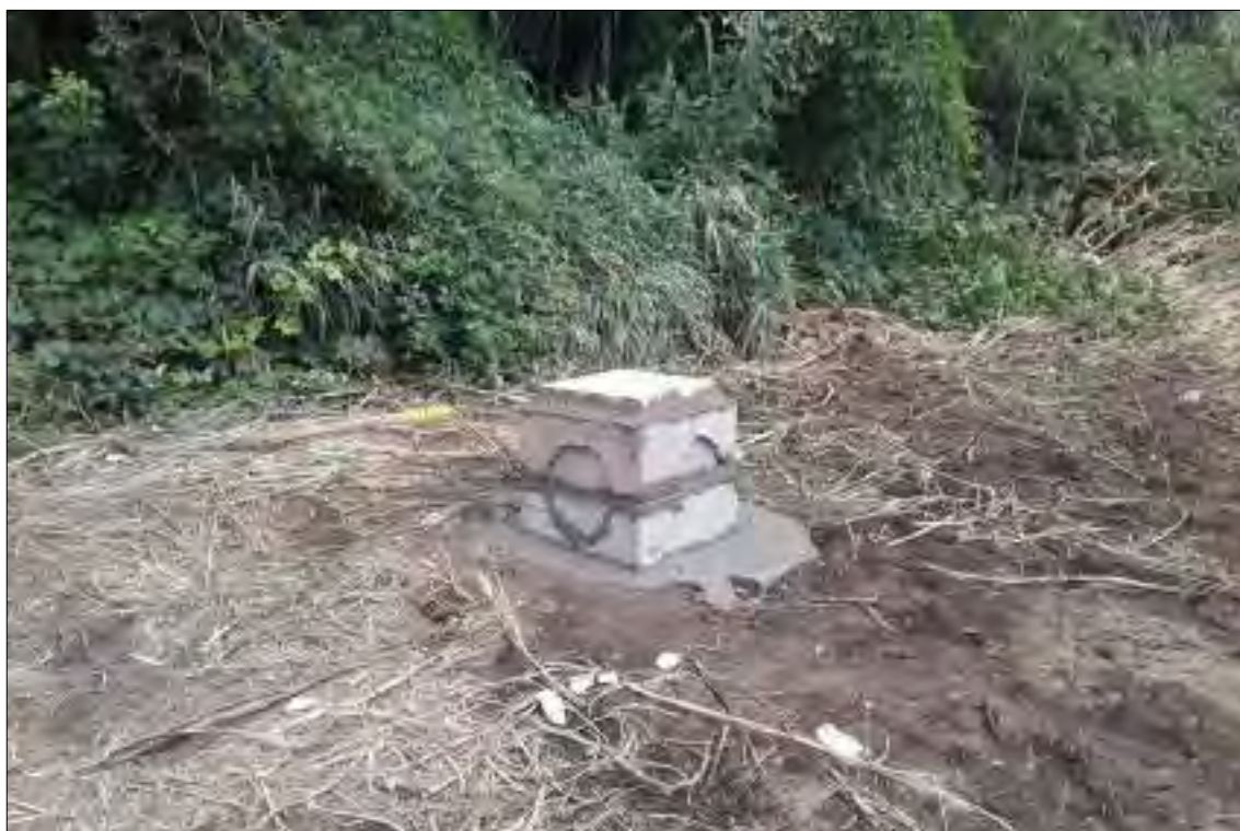
Protezione in calcastruzzo_PZ12
