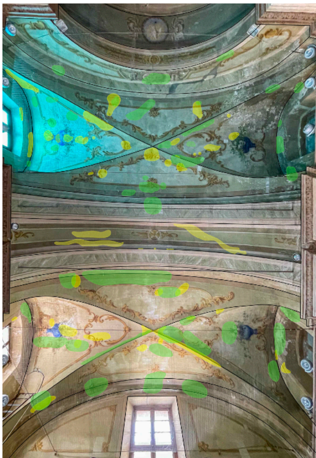
Fig. 1 Mappatura dei distacchi dell'intonaco formati prima (verde) e dopo (giallo) il consolidamento strutturale.
